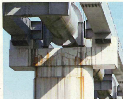
思案橋水管橋下部工のひび割れ
