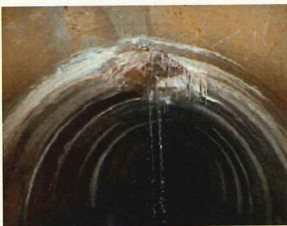
トンネル頂部の欠損
